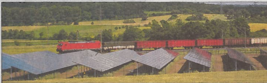
Photovoltaikanlagen entlang von Bahnstrecken werden noch gefördert. Für die beiden Anlagen zwischen Markt Bibart und Altmannshausen (Foto) gilt noch die Einspeisevergütung vom Mai. Fotos: privat
